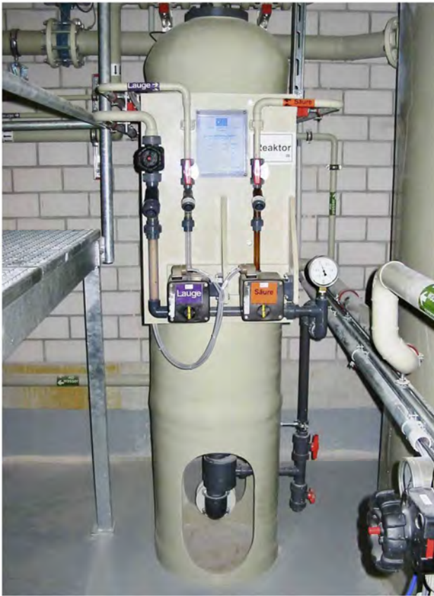
Neutralisationsreaktor, 50 m 3 /h mit spezieller Dosiertechnik der Firma B. Braun GmbH, Lausanne CH
