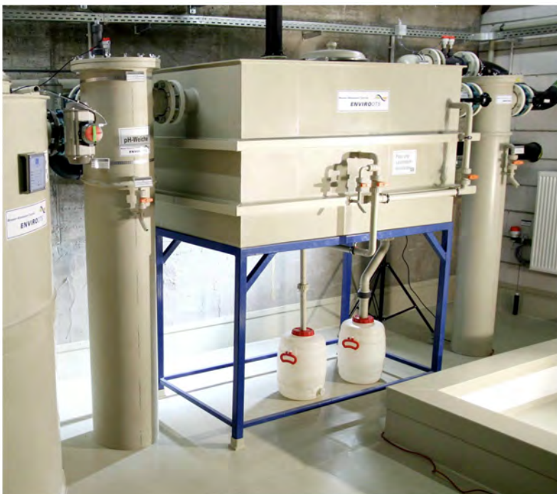
PH-Weiche, Fest- und Leichtstoffabscheider und Schmutzfänger der Anlage Max-Planck-Gesellschaft Heidelberg. Die pH-Weiche leitet neutrales Abwasser direkt über die pH-Endkontrolle zum Kanal. Hierdurch wird unnötiger Chemikalienverbrauch vermieden.
