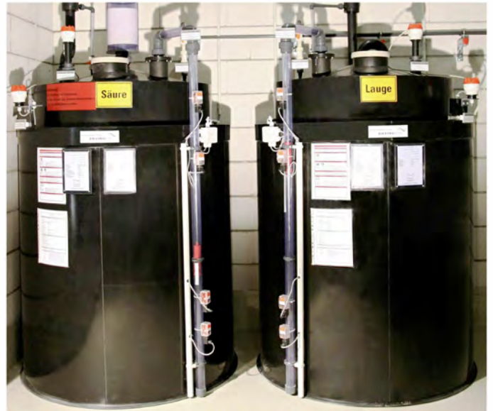
Chemikalienlagerstation ( 2 x 3 m 3 ) zur automatischen Befüllung der Dosierbehälter. Die Chemikalienanlieferung erfolgt über ein doppelwandiges Befüllsystem an der Gebäudeaußenwand.
